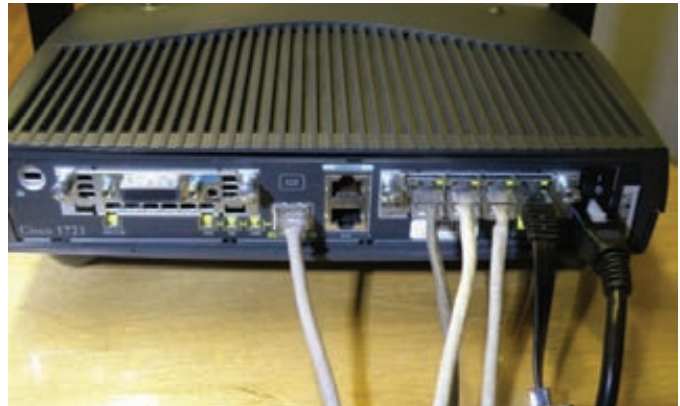
Cisco 1721. Вид сзади. Справа находится модуль WIC-4ESW, слева — Serial порт и по центру — Console
